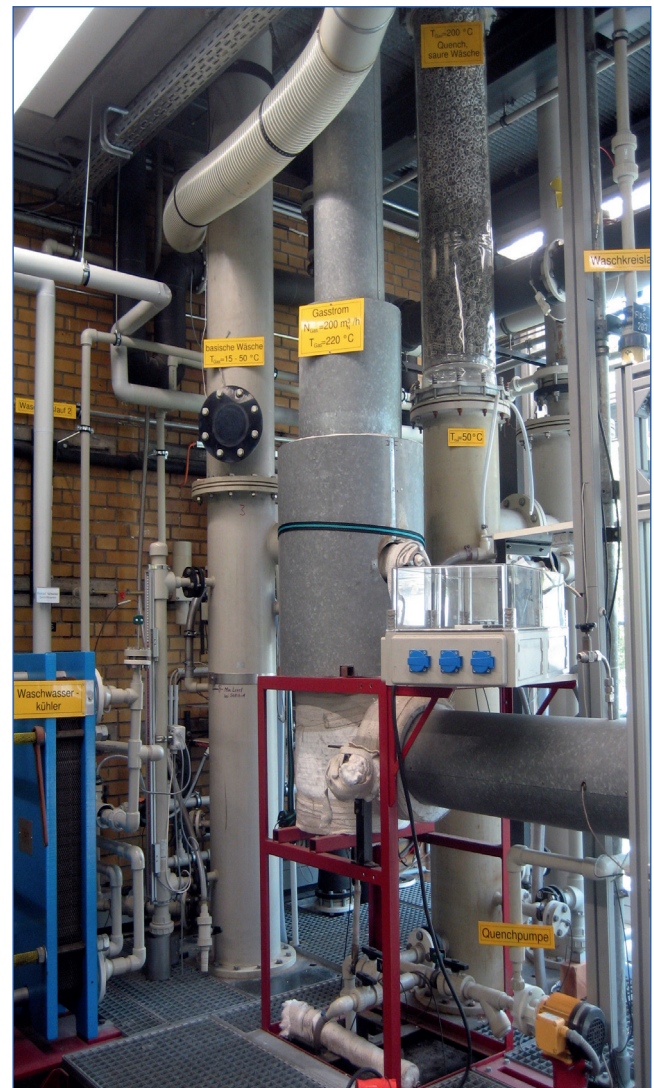
Abb. 5: Rauchgasreinigungsanlage am Institut für Thermodynamik und Kältetechnik des Karlsruher Instituts für Technologie (Foto: KIT)
